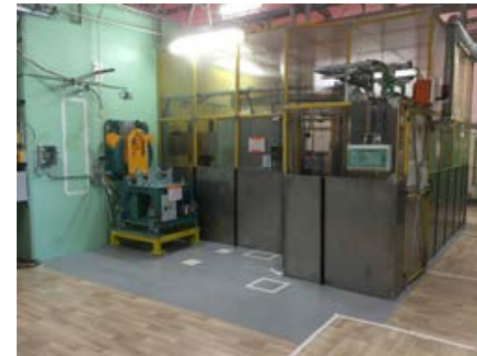
Photo 5 : hall 7004 en attente de raccordement actif
